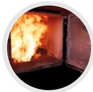
Detalle caldera Biomasa
